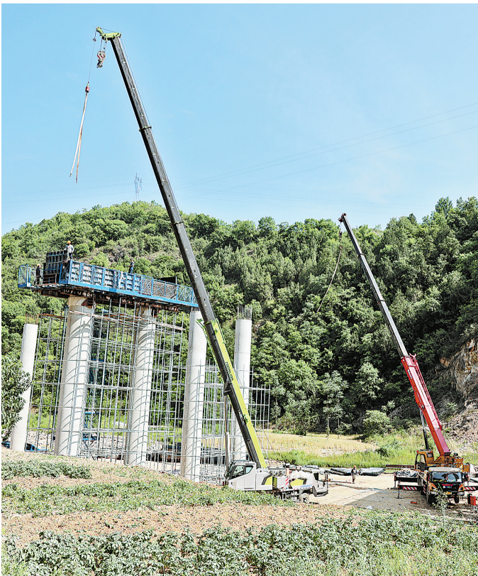
5月27日,在丹宁高速丹凤县土门段建设现场,施工工人正在进行盖梁模板安装施工。该条高速公路的建设对巩固扩大我市交通区位优势,推动陕南及周边地区协同发展,巩固脱贫攻坚成果同乡村振兴有效衔接,具有十分重要的意义。(本报记者 李 敏 摄)
