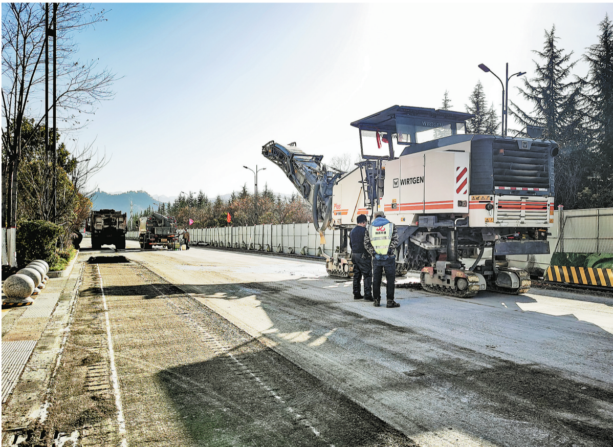
12月23日,市区江滨大道商鞅广场至王塘桥十字路口路面提升改造正在施工。目前,该项目已经完成一侧路面的沥青铺设,车辆可以正常通行,另一侧路面工作人员正在加紧施工,预计2023年1月15日前完工。(记者 王孝竹 摄)
