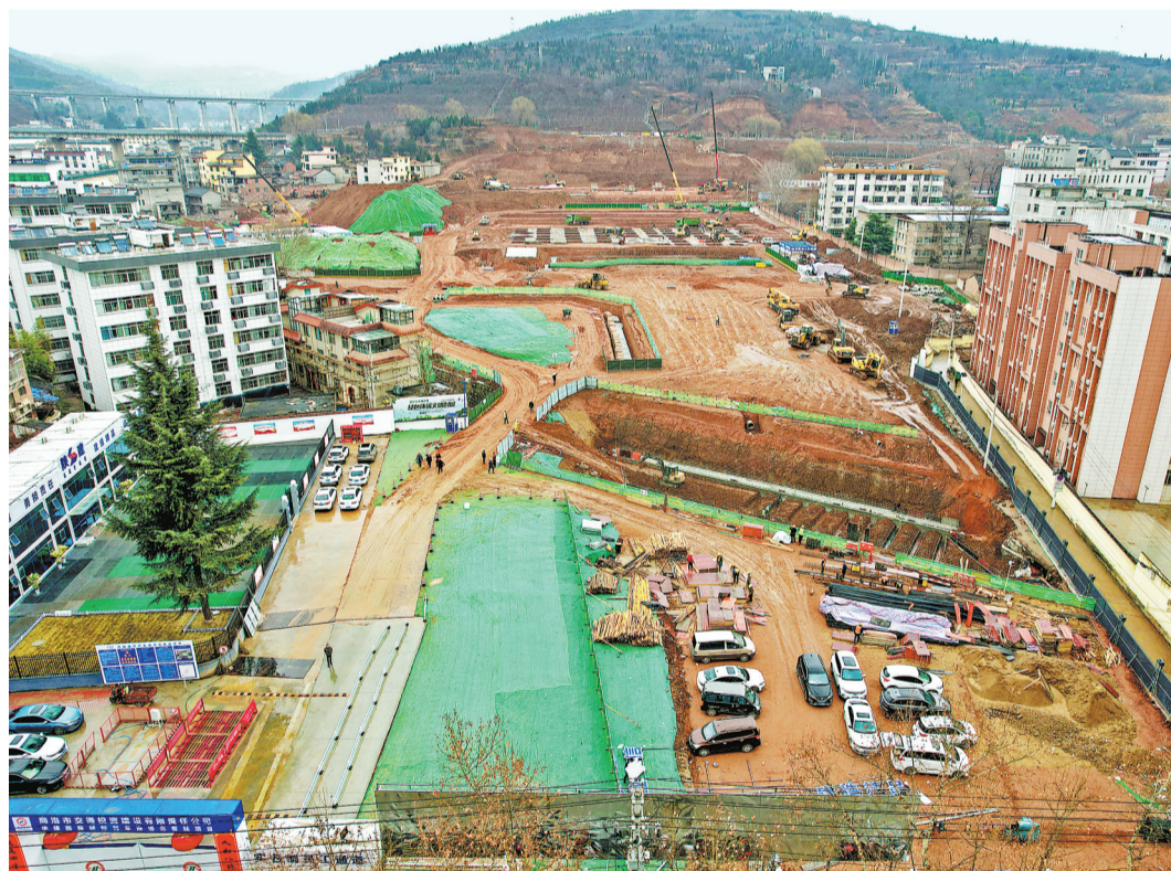
占地约129亩的西商城际列车商洛北客站项目，位于商州区中心城区东侧，建设内容包括北客站站前广场、配套路网及站前公园等。据了解，商洛北客站建成后将开通时速160公里的“绿巨人”列车，让市民出行更加便捷安全。图为2月13日，商洛北客站项目正在紧张有序施工。(本报记者 杨鑫 摄)
