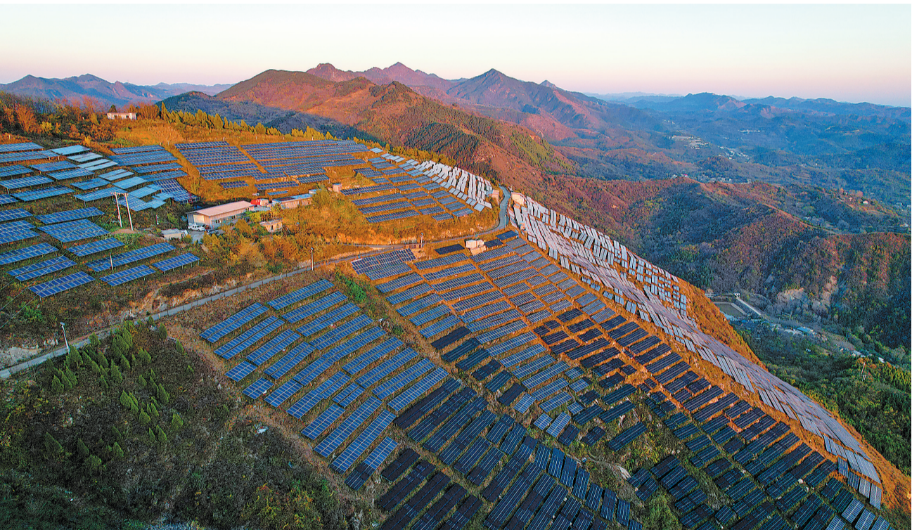
近年来，商州区依托光照充足的自然资源优势，大力引进发展光伏发电产业，并将光伏发电产业与乡村振兴等战略相结合，使新型能源产业成为商州经济发展新的增长极。图为秋日下的商州戴云山光伏电站。（本报记者 杨鑫 摄）
