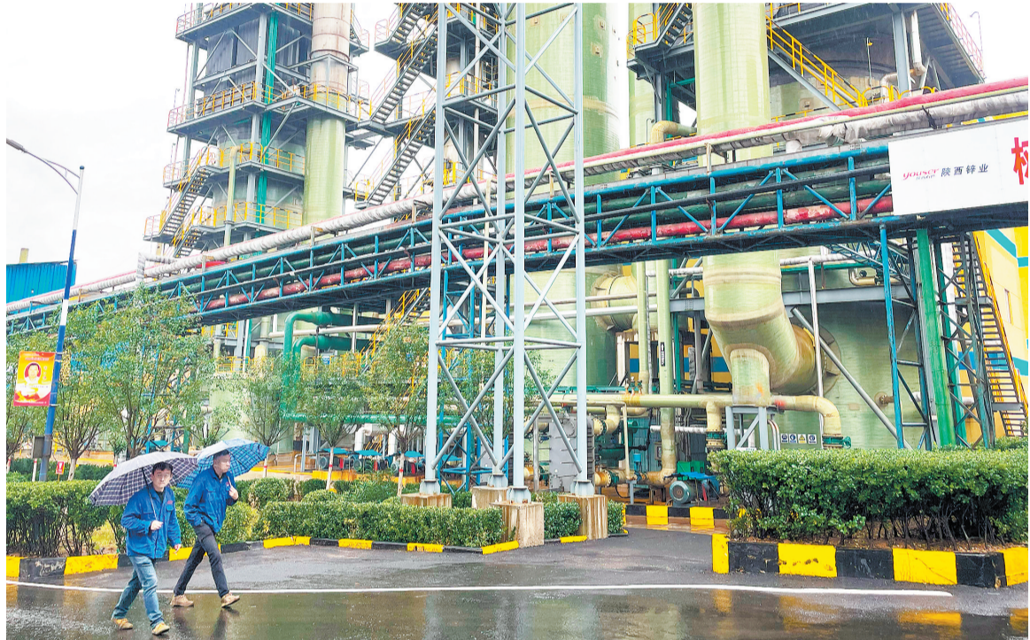
近年来,陕西锌业有限公司先后投资3亿元,建设节能减排、废物处理项目,实现资源高效利用、变废为宝、绿色低碳发展,为企业再次跨越发展开辟“新赛道”。图为11月10日,陕西锌业有限公司炉窑烟气集中深度治理项目平稳运行。(本报记者 谢非 摄)
