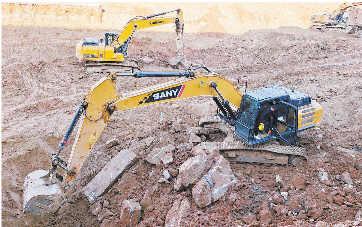
1月2日,商州区电子科技产业园标准化厂房二期项目正在加紧建设中。该项目占地面积20亩,计划建设3.2万平方米钢结构标准化厂房及附属设施。(本报记者 刘桃李 摄)
