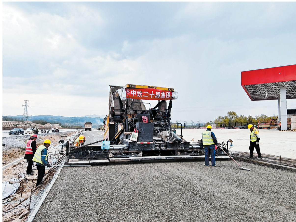
4月16日，由中铁二十局集团承建的陕西洛南至河南卢氏（陕西段）高速公路施工一标段项目土建部分全部完成，目前正在路面水稳层摊铺施工，已经完成总任务的65%，后继沥青面层施工也已展开。（本报通讯员 毕波波 摄）
