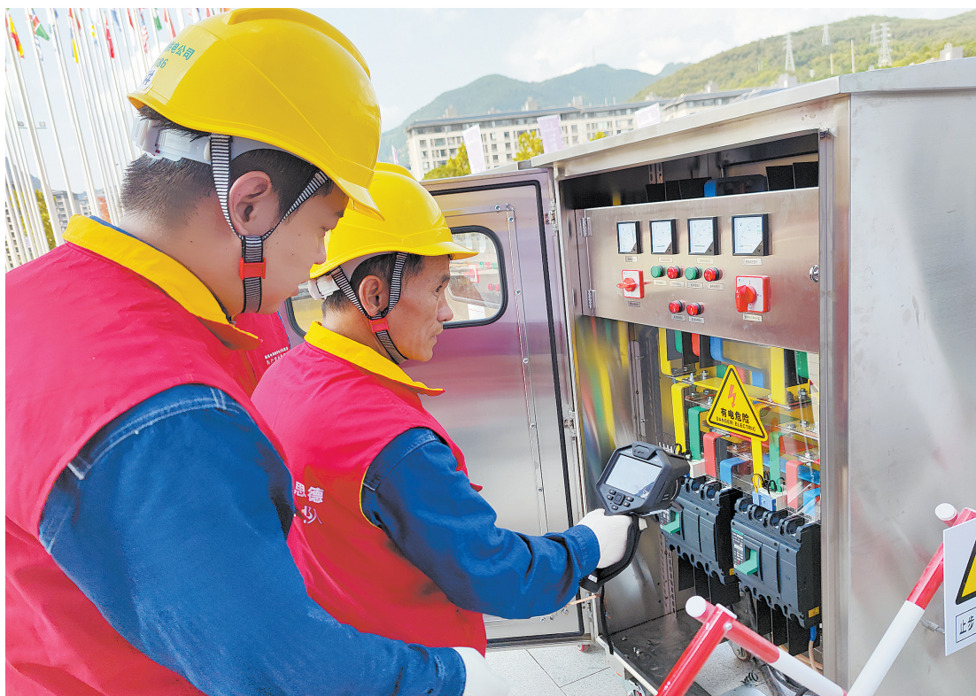
8月23日，国家电网陕西电力张思德共产党员服务队(商洛商州分队)工作人员在2024国际排球沙滩排球U19世界锦标赛赛场对场馆配电箱进行测温。(本报通讯员 熊伟摄)
