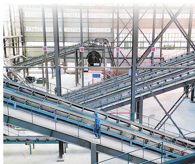
陕西商南镁材料有限公司生产车间内,智能化设备高速运转,各道工序衔接紧密,一派繁忙有序的生产景象。
