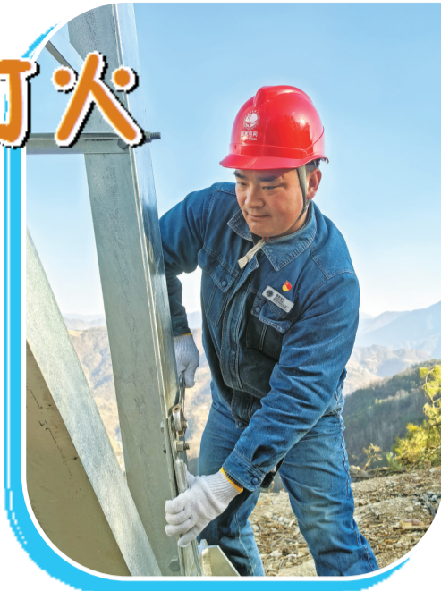
国网商洛供电公司职工李王建在商洛色黑110千伏变电站35千伏送出25#接地线进行检查。
