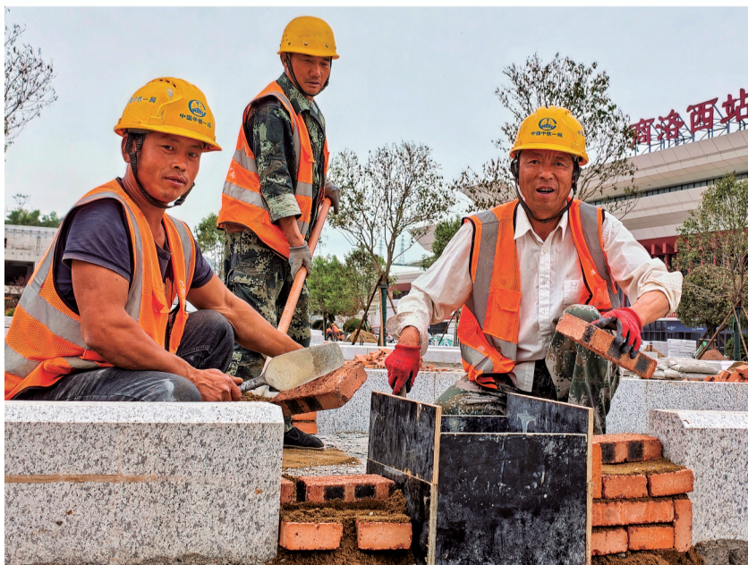
5月3日,任建辉(右一)和工友们正在商洛西站高铁站的建筑工地上固定浇筑磨具,说起建设高铁站他们满脸自豪。
