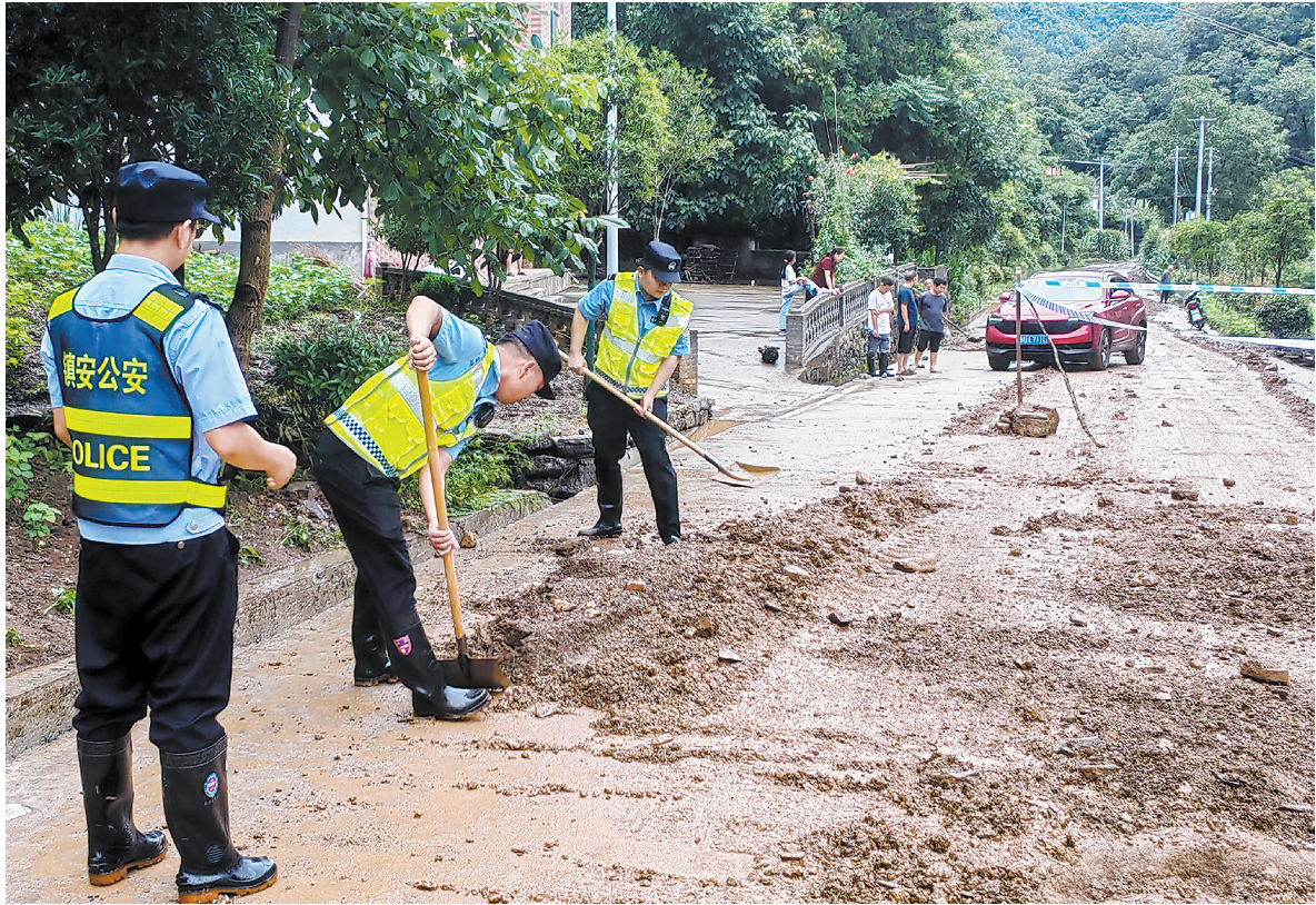
连日来，受持续强降雨影响，镇安县境内多条道路出现塌方、洪水漫路、路面水毁险情。当地公安闻“汛”而动，迅速开展交通管控、隐患排查、抢险排涝、救助群众等工作。图为8月5日，民警在铁厂镇三里峡至米粮镇联盟村、茅坪回族镇甘沟口路段抢通塌方道路，保障群众出行安全。（本报通讯员 陈玉 摄）
