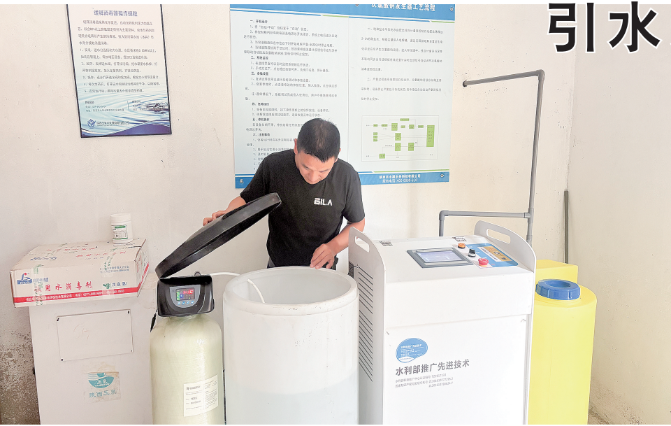
土门镇水管员正在查看饮用水净化消毒使用情况。
