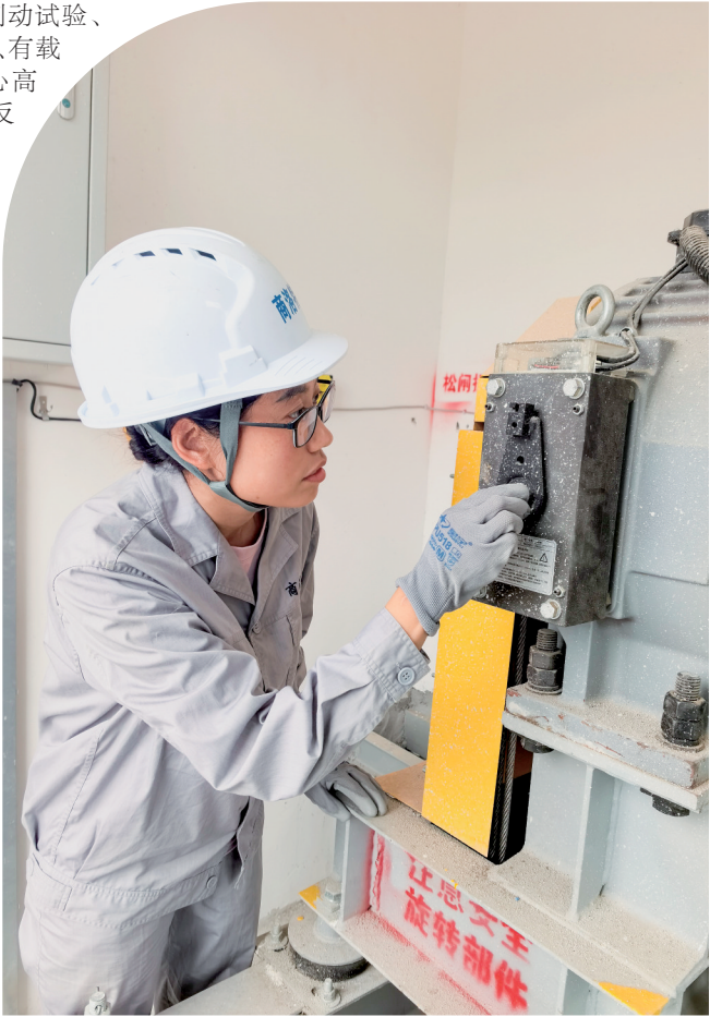
麻丹丹在电梯井里认真核定电梯运行数据，确保每一部电梯运行安全。
