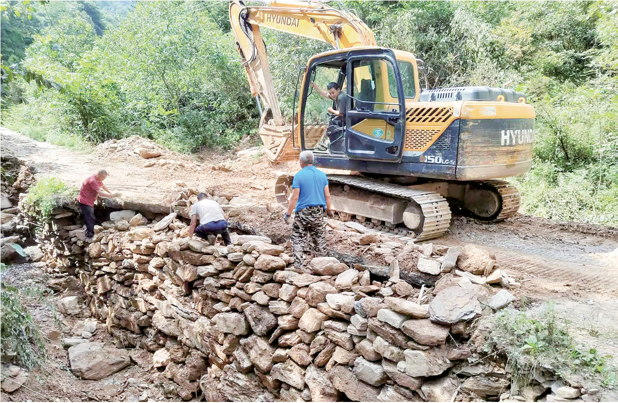
8月份,受强降雨影响,河水暴涨,致使山阳县城关街道下河村吉家沟道路严重受损,出现路基掏空、路面塌陷泥泞、排水沟渠堵塞积水等问题。村民们自发组织、自愿参与,筹集修路资金,从8月23日至9月中旬修复水毁道路1.74公里,使原本泥泞难行的险路焕然一新,有效消除了道路安全隐患。
